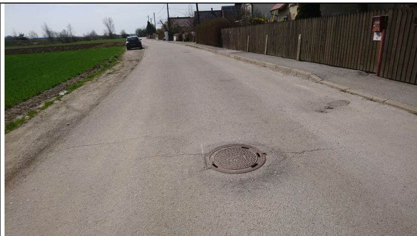
VIDNE POŠKOVBE VOZIŠČA , POSEDANJE OKOLI PROKROVOV JAŠKOV, RAZPOKE V VOZIŠČU IN POŠKODBE BETONSKIH ROBNIKOV.
